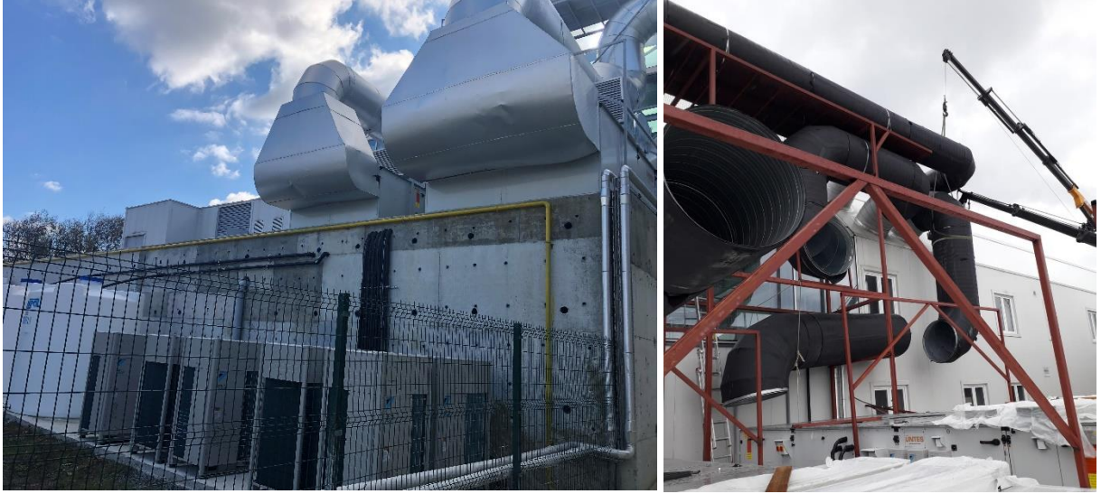
Kilyos Kampüsü Yosun Serası Havalandırma ve Vrf klima sistemi
