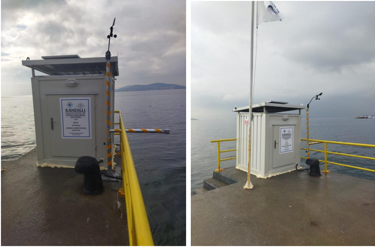
Şekil 1. Kartal’da 24 Ocak 2024 tarihinde kurulan çok disiplinli tsunami gözlem ve erken uyarı istasyonu.
