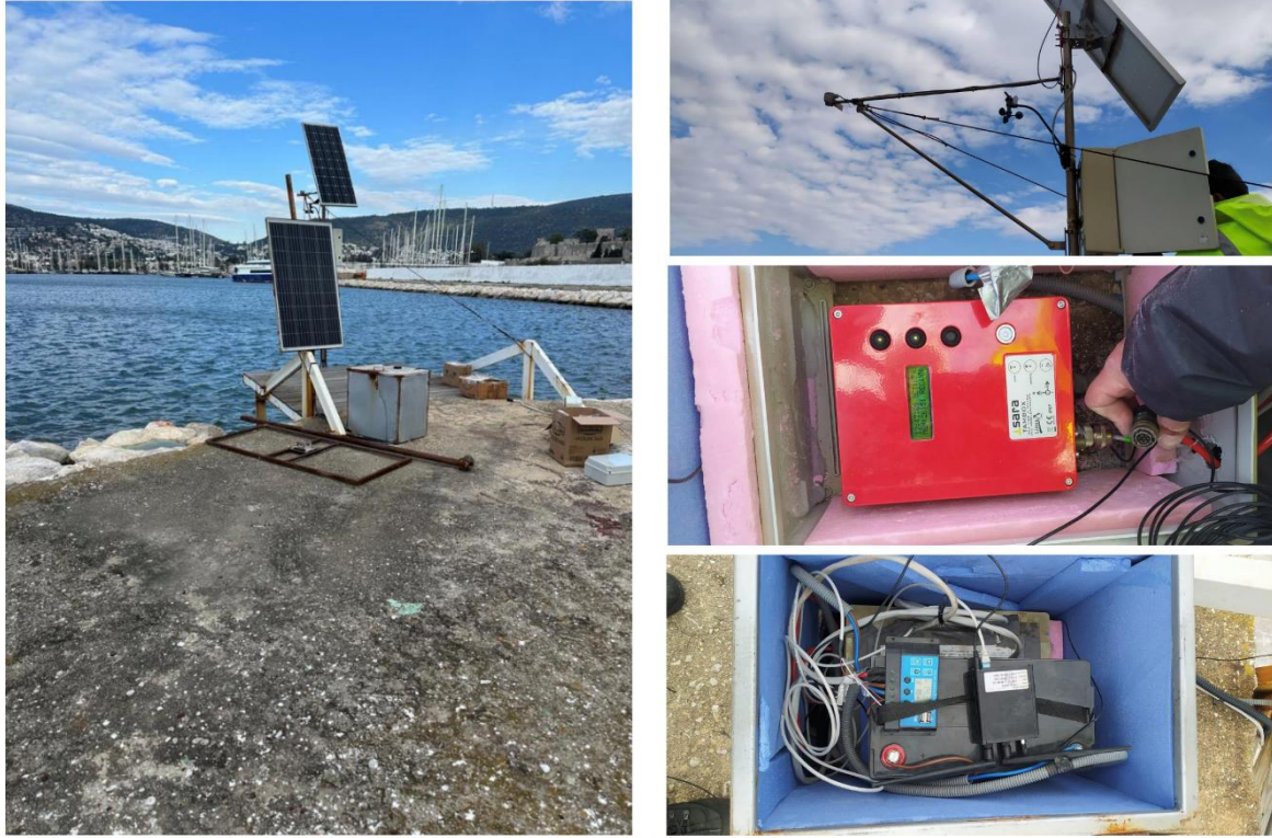
Şekil 2. Bodrum Muğla’da 19 Şubat 2025 tarihinde kurulan çok disiplinli tsunami gözlem ve erken uyarı istasyonu.
